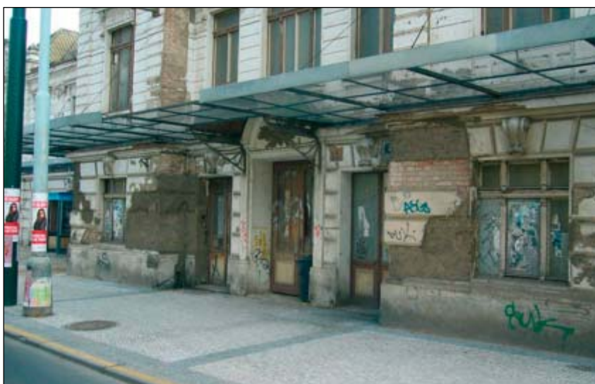
Obr. 12: Detail záchytných sítí podél budovy nádraží, které brání zranění chodců padajícími kusy omítky
