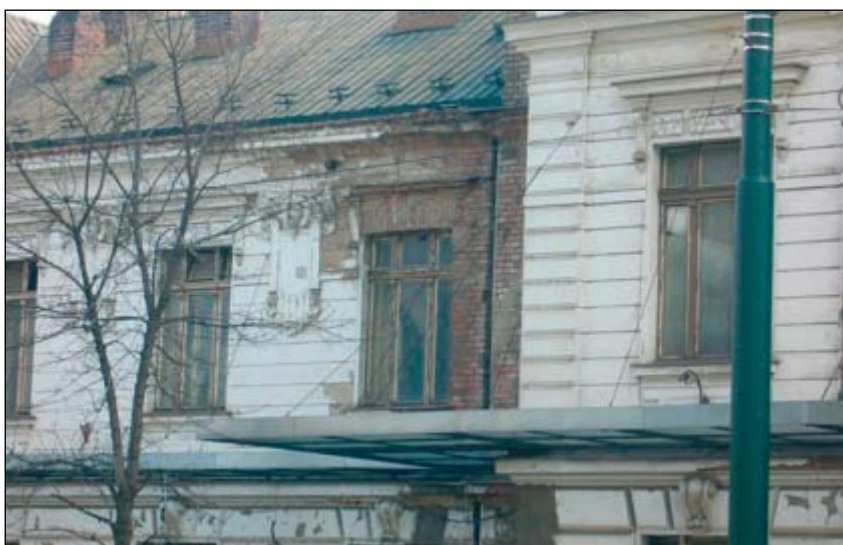
Obr. 13: Degradace omítky pokračuje na mnoha místech fasády
